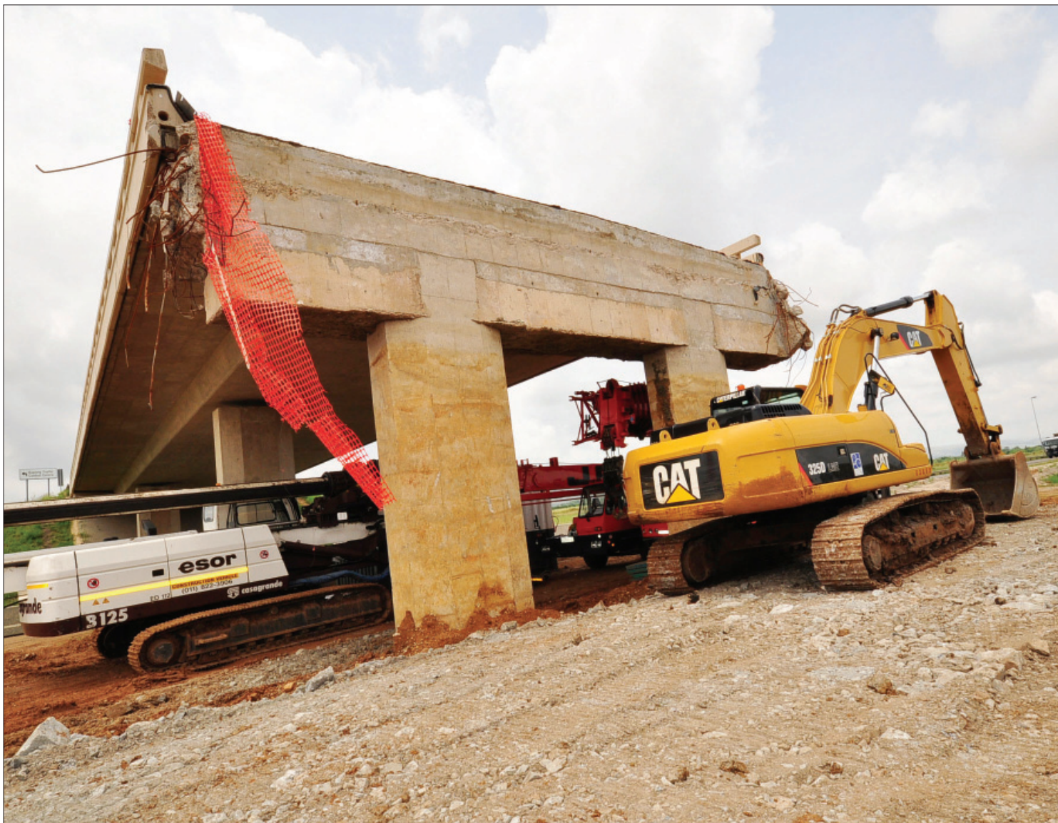
'n Toneel wat tans meer na verwoesting as ontwikkeling lyk - gelukkig is laasgenoemde waar. 'n Bedrag van nagenoeg R500 miljoen gaan oor die volgende vier jaar deur Bakwena bestee word in die ontwikkeling van 'n tweede eenrigting-dubbelbaan op die N4 Platina-tolpad tussen die R512 Wes en die Marikana B2236-wisselaar - 'n stap wat hopelik verligting van swaar
